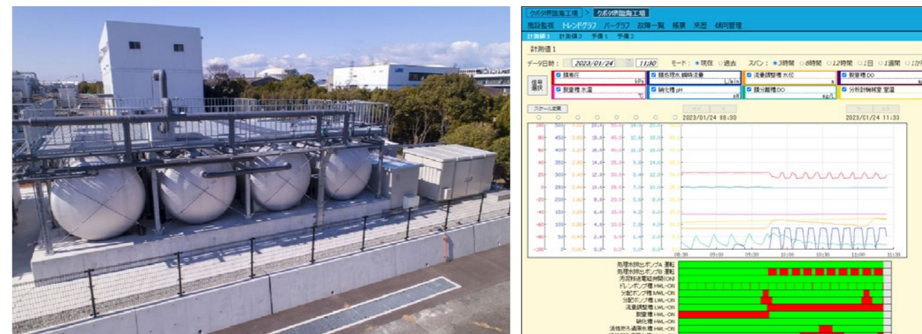
クボタ堺臨海工場では、液中膜方式のFRP浄化槽を増設しました。生活系廃水の高度処理が可能で、1日当たり最大110m 3 の排水を処理することができます。また、BCP対策として、排水処理施設のコンクリート基礎の高上げを行いました。IoTを活用した水管理ソリューションシステム「KSIS」を導入し、工場排水の適切な管理を実現しています。
