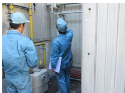
環境リスクアセスメントの様子 クボタ筑波工場
