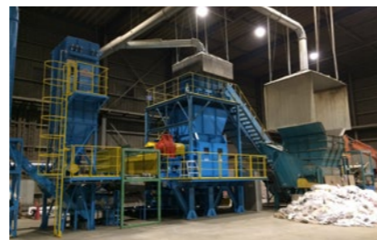
プラスチック破碎選別施設
