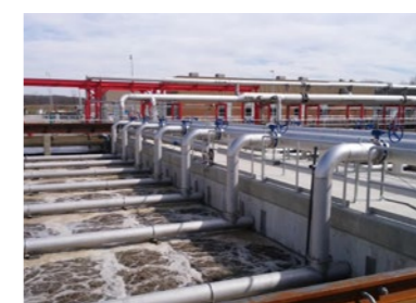
排水の再生処理にも活用される液中膜
