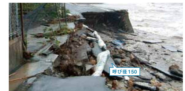
道路崩壊 | 台風被害、大分県臼杵市
