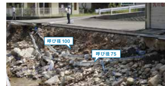
道路崩壊 | 台風被害、愛媛県松山市
