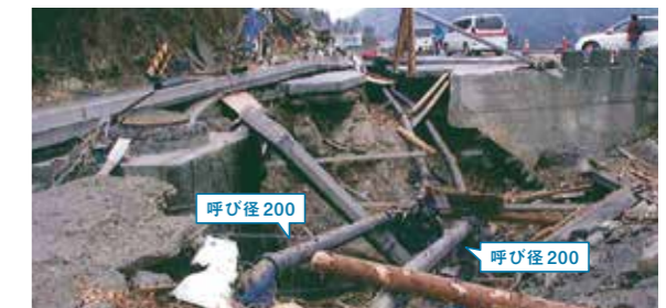
道路崩壊 | 東日本大震災、岩手県宮古市
