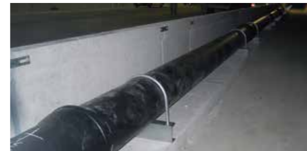
道路トンネル(消火配管)
