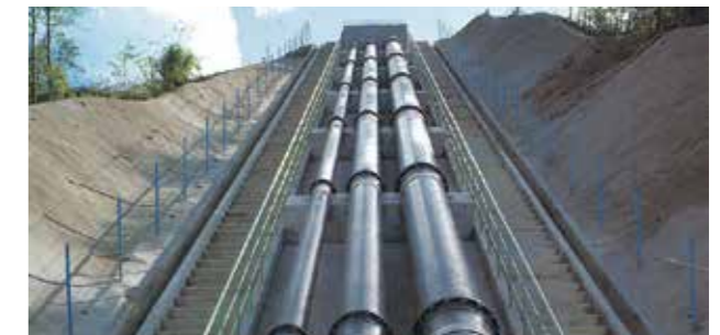
発電(傾斜地配管)
